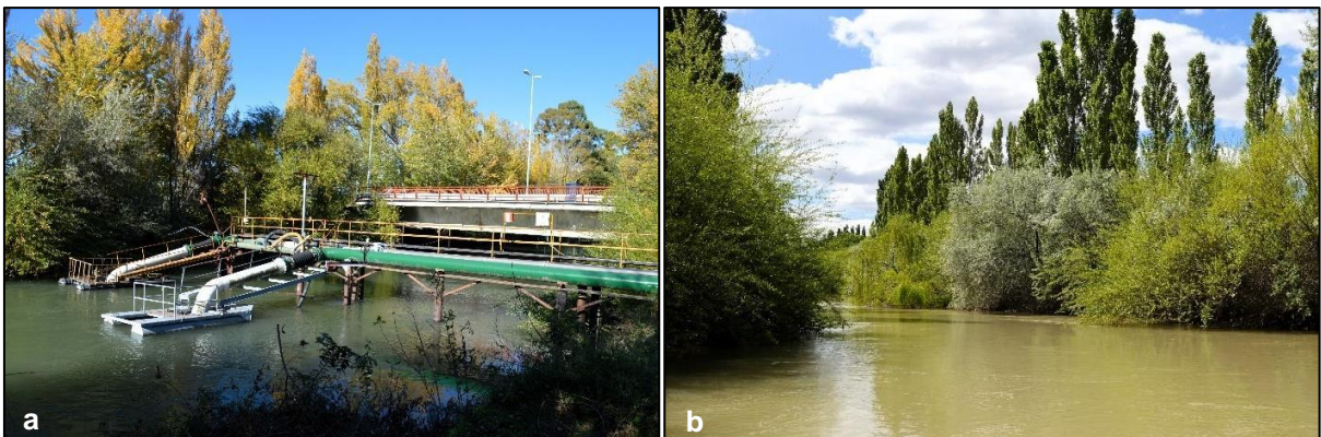
Figura 4. Sitio III: Planta potabilizadora de Trelew (Tw). (a) Tomas de agua; (b) vista desde la toma.
