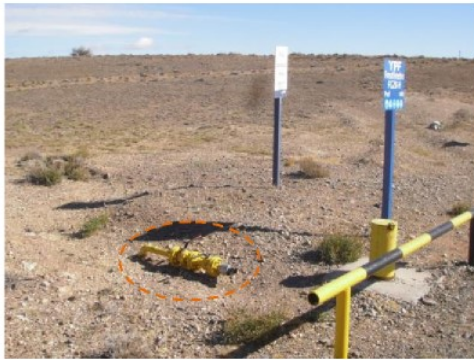
Vista de detalle de la boca de succión del sistema de purga
