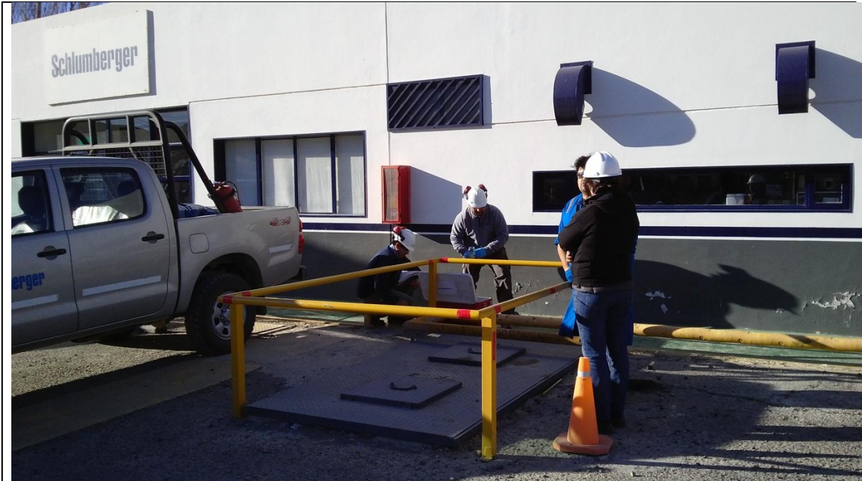
Sistema de tratamiento instalación exterior soterrada
